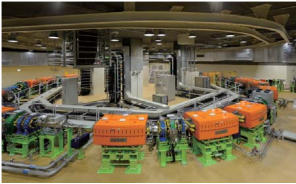
写真3 シンクロトロンの外観。
